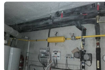
Caractéristiques installations parties communes / Pour alimenter la chaufferie
