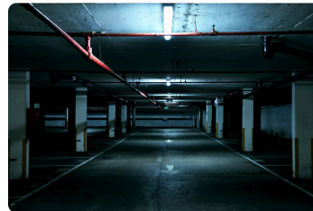
Entretien général et désordres / Marquages au sol à refaire. Eclairage à revoir, trop faible.
