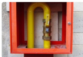
Caractéristiques installations parties communes / Organes de coupures et de sécurité
