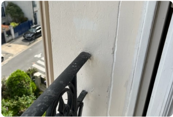
Entretien général et désordres / Fissures de nombreux jambages de fenêtres
