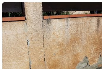
Entretien général et désordres / Murets fissurés
